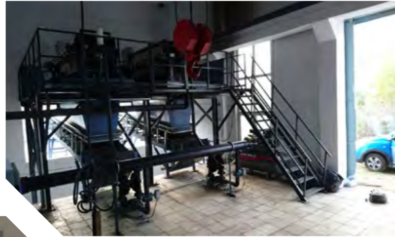
KARABÜK BELEDİYESİ KENTSEL ATIKSU ARITMA TESİSİ ÇAMUR SUSUZLAŞTIRMA TESİSİ KAPASİTE: 1000 m 3 / Sa
